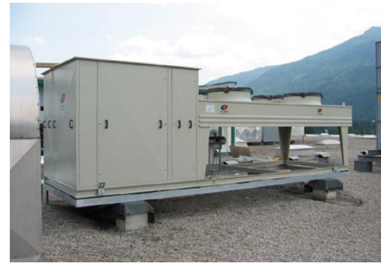
Flüssigkeitskühlsatz der KWN Engineering-Gesellschaft (indirekte Anlage, Kältemittel „schick R723“, Kälteleistung 230 kW, Hauptkomponenten zwei Hubkolbenverdichter mit luftgekühltem Verflüssiger) Realisierung, Montage und Inbetriebnahme der Anlage durch Axima Kältetechnik GmbH aus A-6923 Lauterach/Österreich
